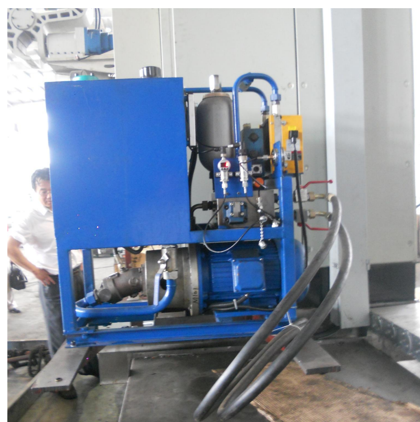
图3 液压定向机械臂液压站
